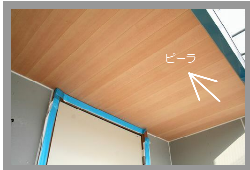
玄関ポーチの天井です。Pierの板張りがとってもきれいです。玄関部分は、アクセントにタイルを張る予定です。
